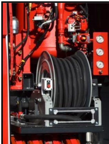
Рукавная катушка системы порошкового пожаротушения
